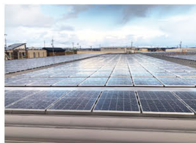
太陽光パネル
