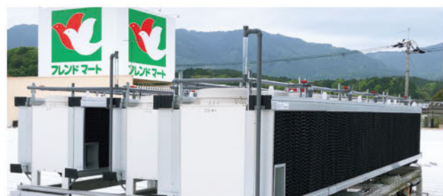
冷蔵ケース室外機クーリングシステム
