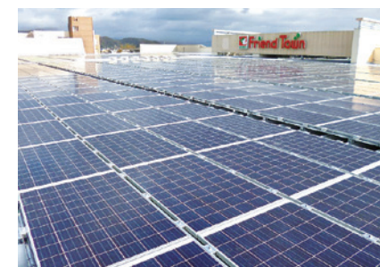
太陽光パネル
