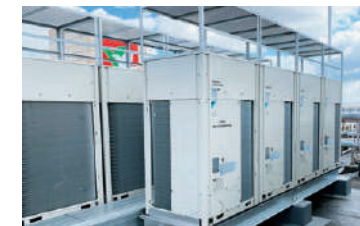
▲更新した冷媒機
