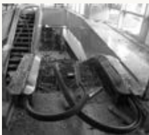
大きく曲がったエスカレータの手すり
