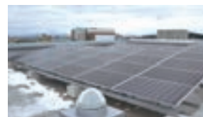
太陽光発電設備
